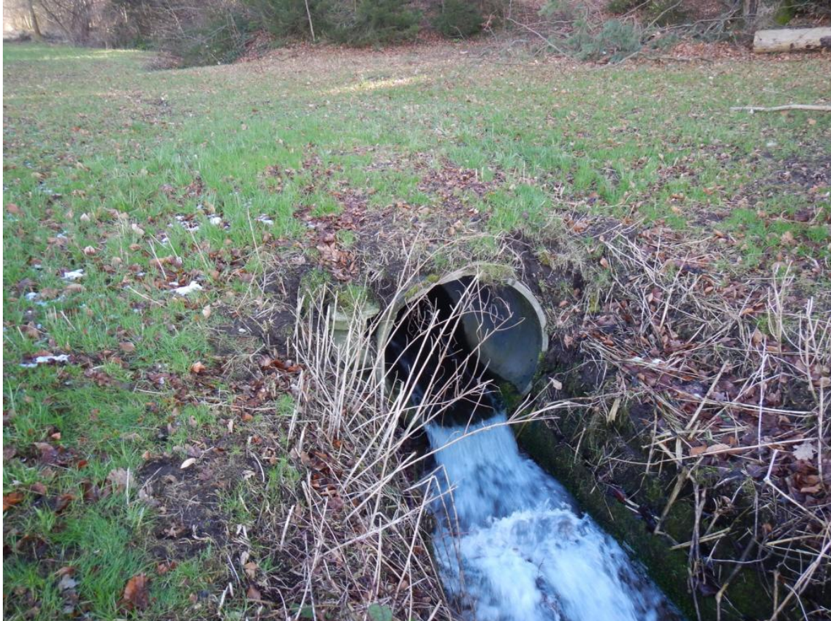
Abbildung 10: Fehlende Durchgängigkeit am Betznauer Bach, BB029
