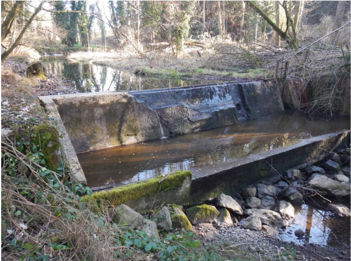
Abbildung 9: Fehlende Durchgängigkeit am Nonnenbach, NB041
